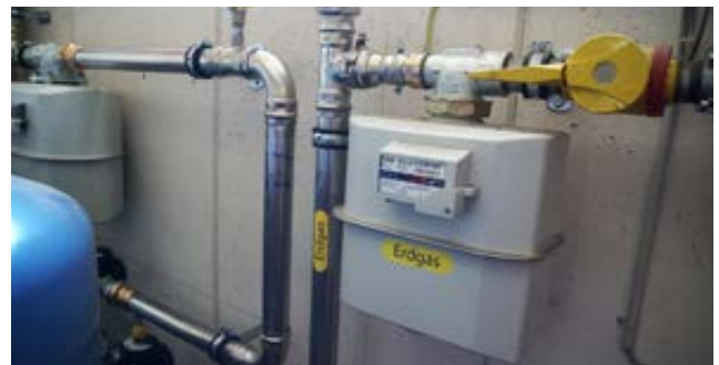
Durch den Erdgasanschluss entfällt der Beschaffungsaufwand bei der Energie fast gänzlich
